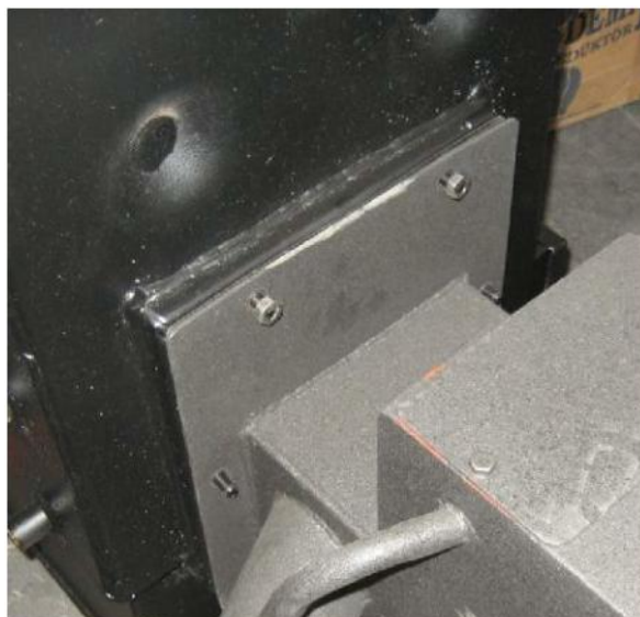
Рисунок 9. Установленный на котле корпус шнековой подачи.
